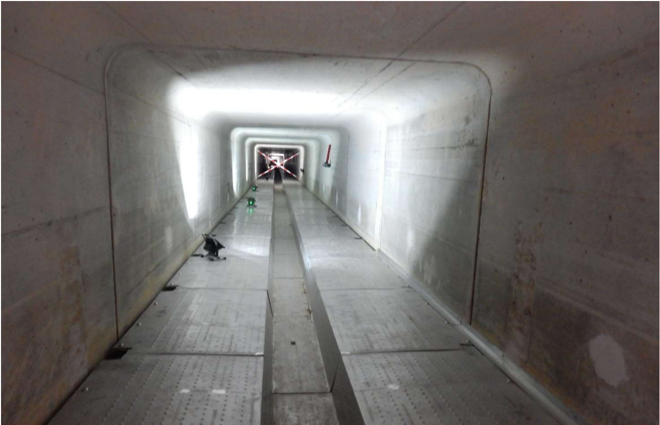
Abb. 4 Nachträglich einsetzbares Wärmetauschermodul im Kanal (Neckarpark, Stuttgart)
